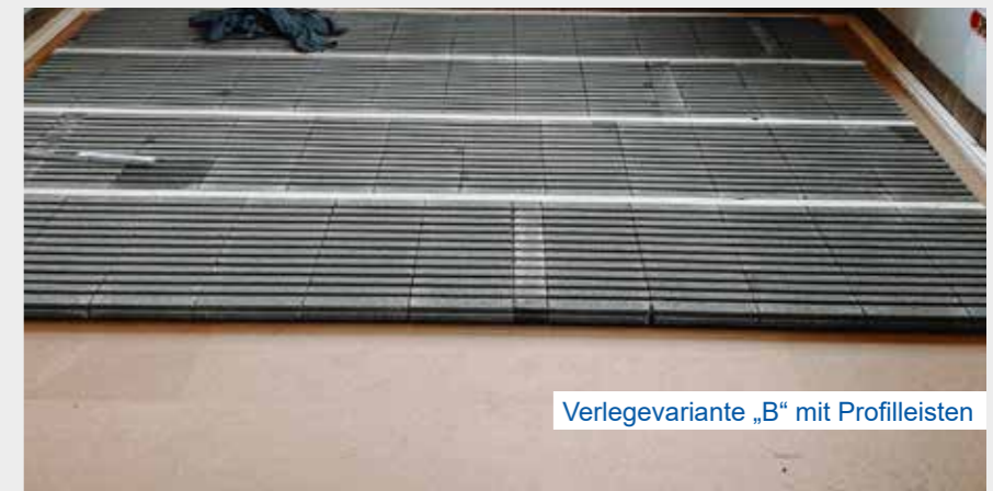
Anbindung zum Heizungsverteiler
